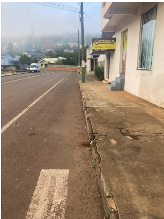
Figura 41 - Passeio com boa pavimentação e sem acessibilidade
