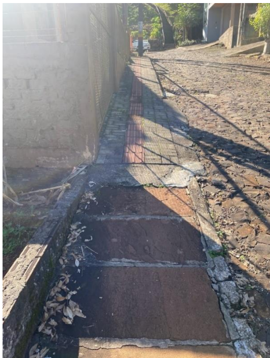
Figura 44 - Passeio estreito e pavimentação descontinua
