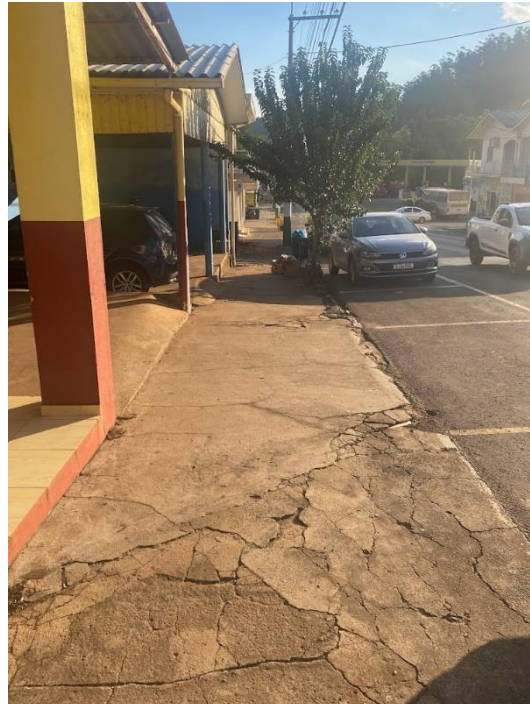
Figura 45 - Passeio com pavimentação regular e sem acessibilidade
