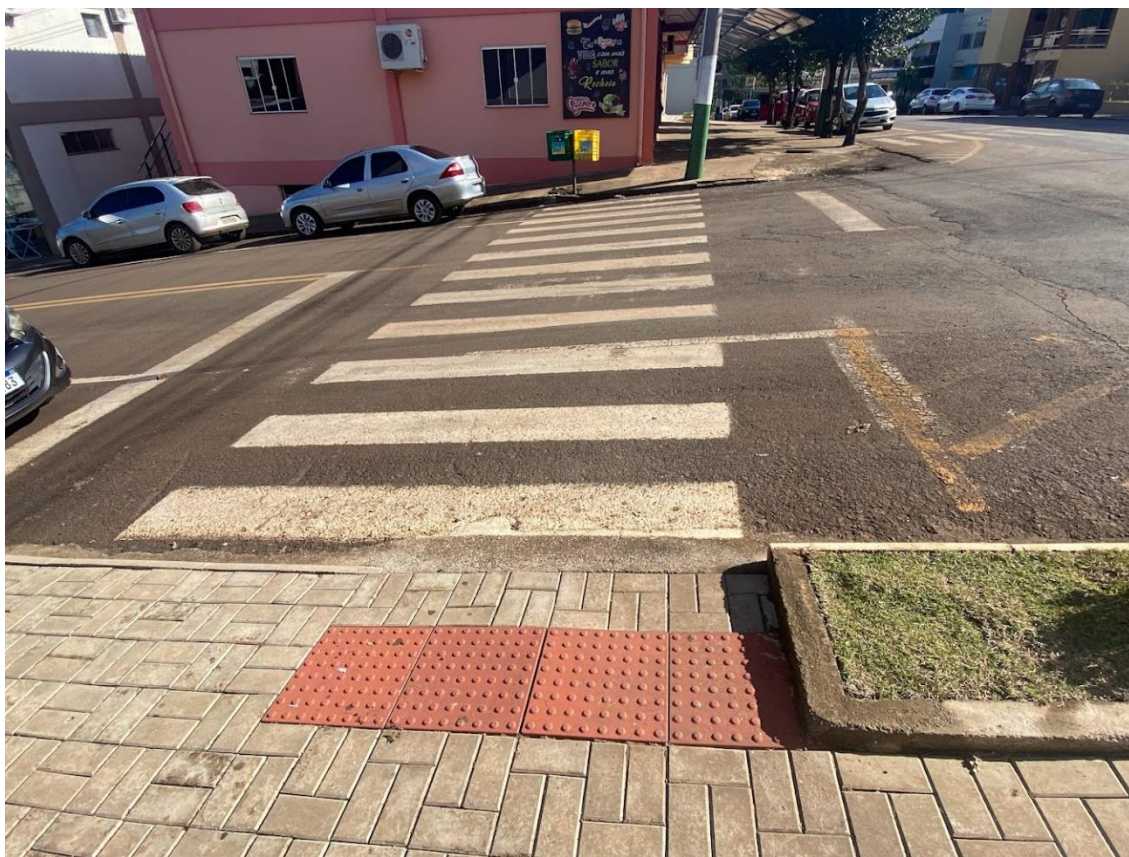
Figura 54 - Acessibilidade de esquina desconforme com a NBR-9050
