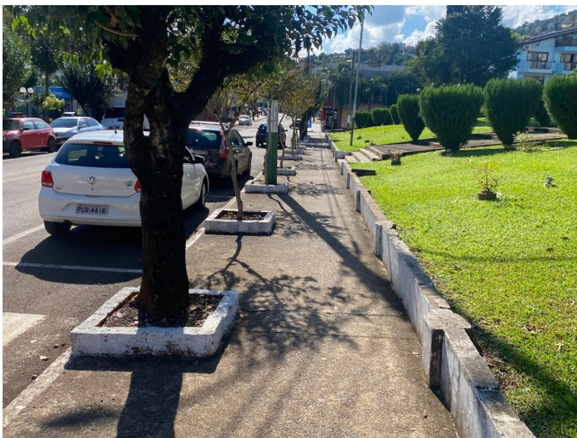
Figura 40 - Passeio com boa pavimentação e sem acessibilidade
