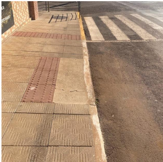
Figura 42 - Esquina sem rebaixe de meio fio para PCD
