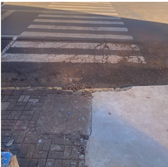
Figura 41 - Rebaixe de meio fio desconforme com a NBR-9050
